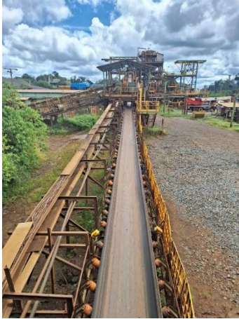
Figura 7 - Correia Transportadora CV-03
