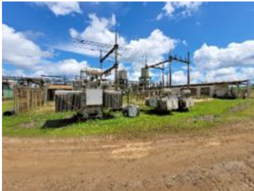
Figura 62 - Subestação elétrica principal (2)
