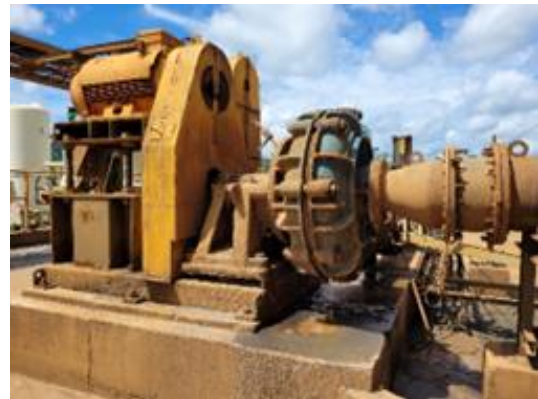
Figura 54 - Bombas de rejeito WEIR MINERALS
