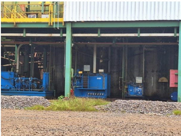
Figura 15 - Unidade Hidráulica Moinho Bolas
