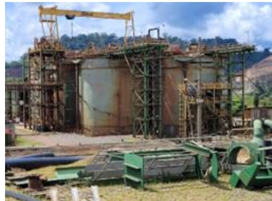
Figura 34 - Conjunto de 7 tanques em aço carbono CIL
