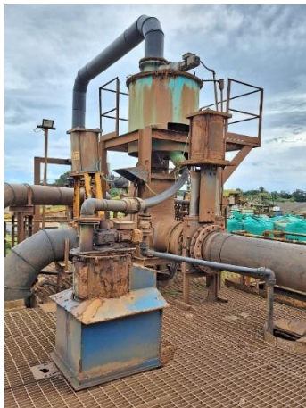
Figura 63 - Amostrador Automático Alimentação
