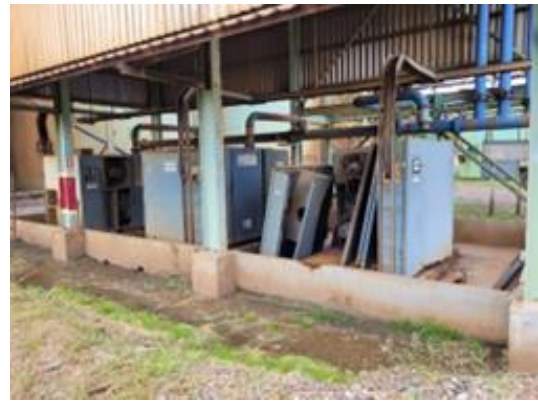
Figura 53 - Conjunto de Compressores de ar CHICAGO
