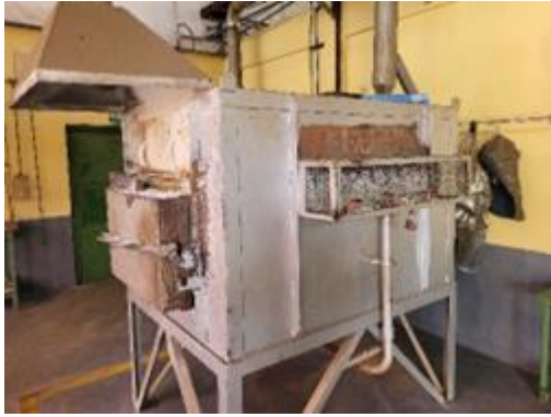
Figura 47 - Conjunto de 2 Fornos a gás laboratório químico Hosken
