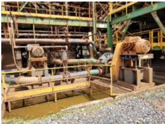
Figura 15 - Bomba UF Moagem WEIR MINERALS
