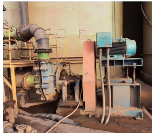
Figura 48 - Bomba de Recirculo de Polpa
