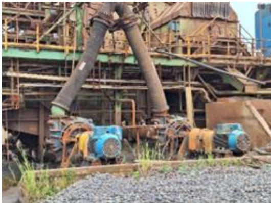
Figura 14 - Bombas de descarga para moagem WEIR MINERALS
