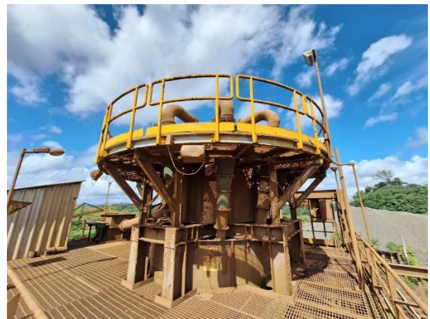
Figura 17 - Bateria de Ciclones
