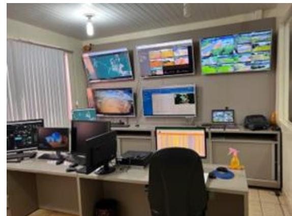
Figura 76 - Manutenção e sala de controle (2)
