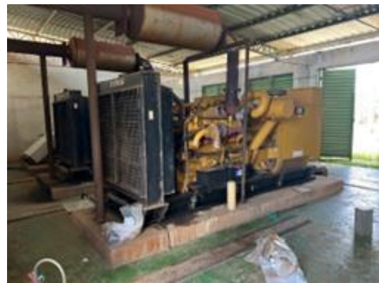
Figura 60 - Conjunto com 2 de Grupo Geradores de energia
