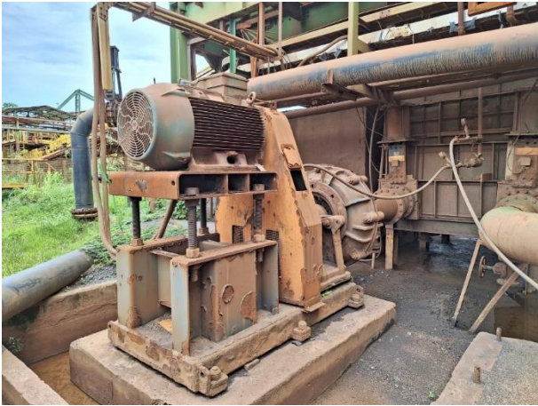
Figura 19 - Bombas Underflow Peneira Moagem
