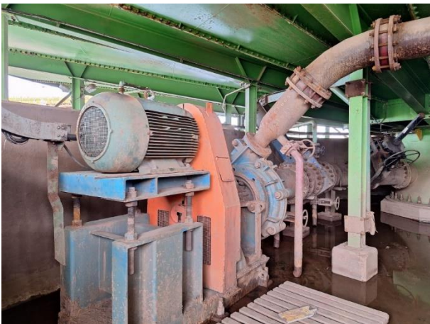
Figura 21 - Bombas Underflow Espessador
