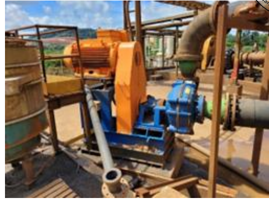
Figura 37 - Conjunto de 3 bombas WEIR MINERALS (2)
