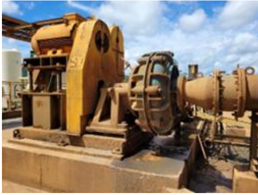
Figura 36 - Conjunto de 3 bombas WEIR MINERALS (1)
