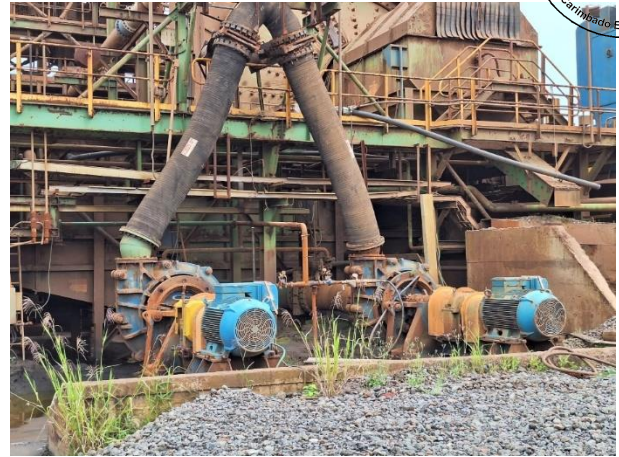
Figura 16 - Bombas de Descarga do Moinho
