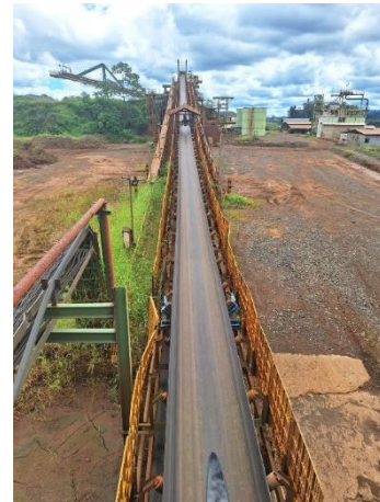
Figura 4 - Correia Transportadora CV-01
