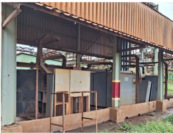
Figura 68 - Compressores de Ar
