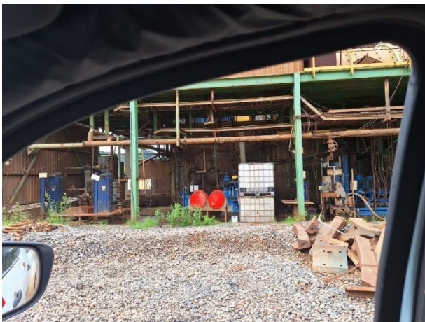
Figura 14 - Unidade Hidráulica Moinho SAG
