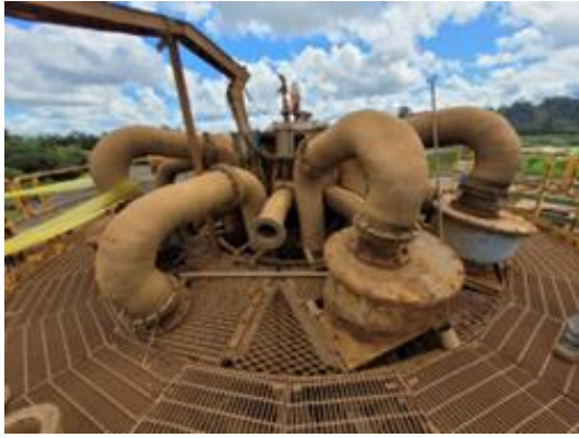
Figura 13 - Bateria de ciclones composta por 10 ciclones
