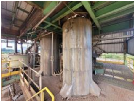
Figura 39 - Conjunto com 2 colunas de eluição em aço inox IBERICA
