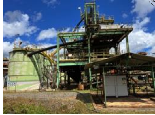
Figura 58 - Conjunto de 2 tanques de cal
