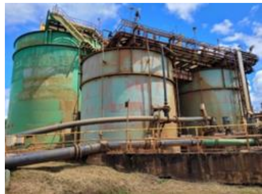
Figura 35 - Conjunto de dois tanques DETOX
