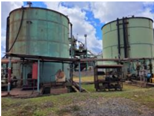
Figura 57 - Conjunto de 2 Tanque de água de processo
