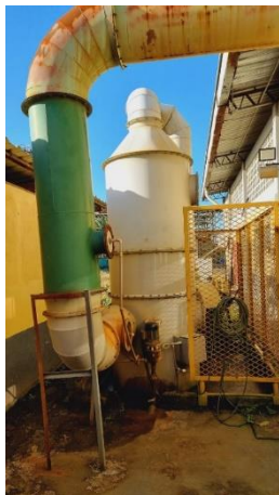
Figura 57 - Lavador de Gases
