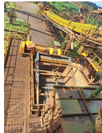
Figura 18 - Trash Screen – Moagem
