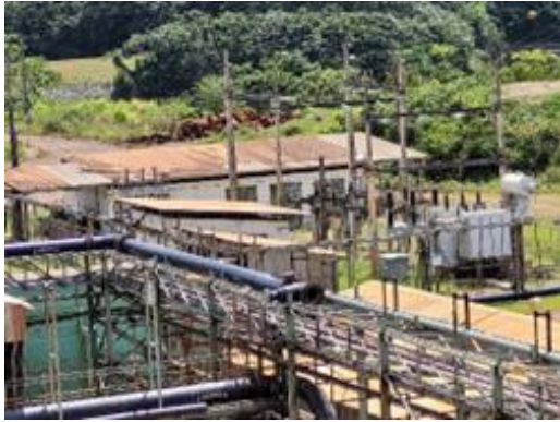
Figura 61 - Subestação elétrica principal (1)
