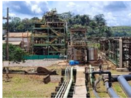
Figura 59 - Tanques em aço inox para armazenamento de produtos químicos
